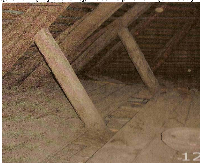
Rysunek 14 Detale połączenia więźby dachowej, widoczne przemoknięcia i ślady zużycia
