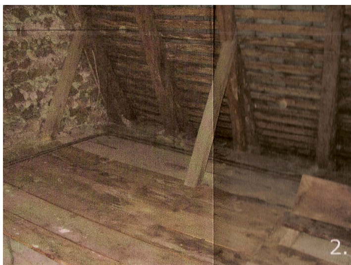
Rysunek 1 Fragmenty istniejącej więźby dachowej, widoczne uszkodzenia i zagrzybienia
