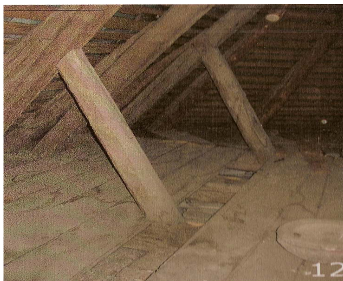
Rysunek 2 Detale połączenia więźby dachowej, widoczne przemoknięcia i ślady zużycia
