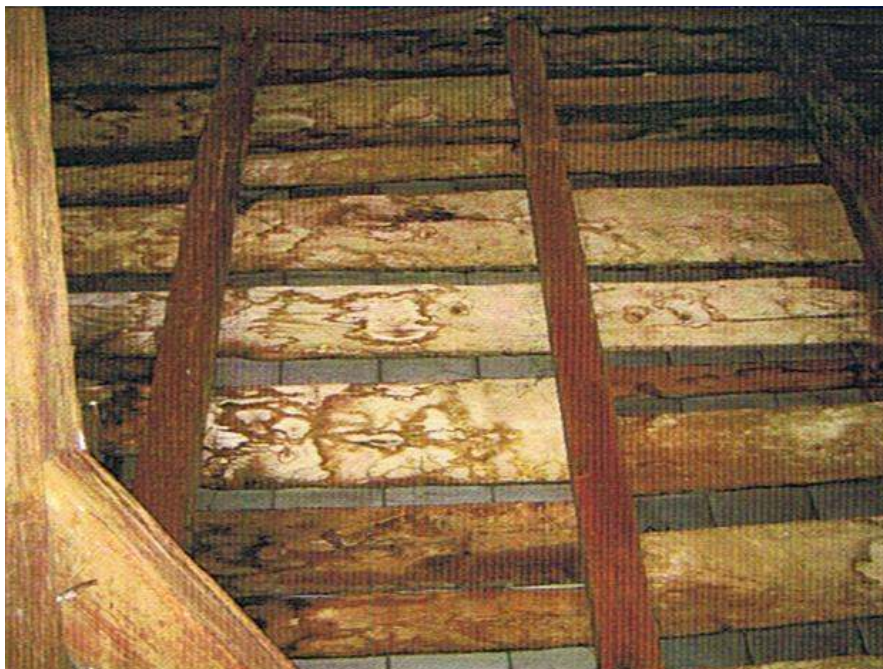
Zdjęcie 11 Ślady przecieków i zagrzybienie deskowania
